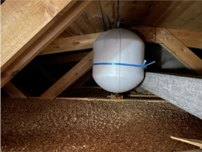
Vindsutrymme. Expansionskärl rekommenderas att ersättas med tryckkärl i källaren.
