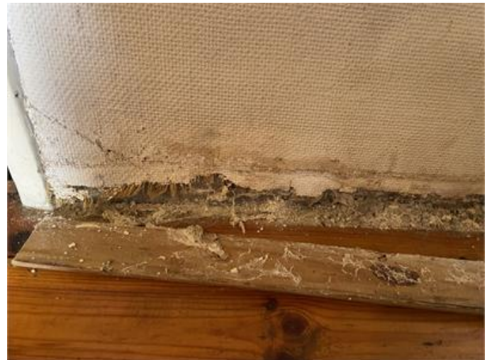
Fuktrinrängning källarväggar, innervägg.
