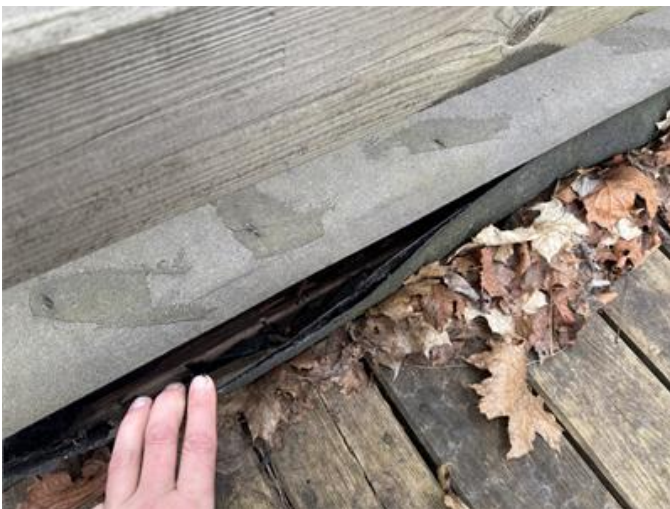
Rötskador noterades i skarven mellan papptak och balkong.
