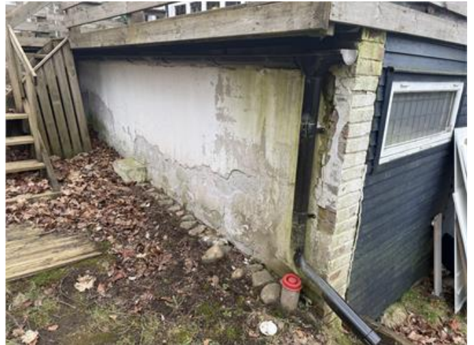
Putssläpp från grundmuren.
