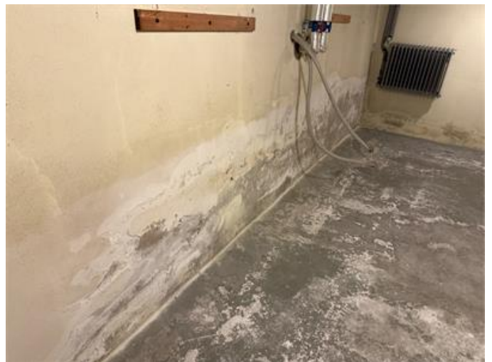
Fuktgenomslag förekommer på källarväggar/golv.
