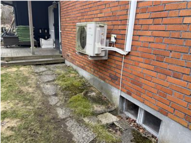
Kondensvattnet leds inte bort från luftvärmepumpen.
