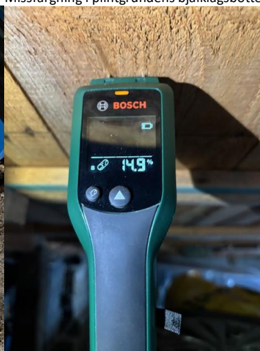
Fuktkvot i virke i krypgrunden
