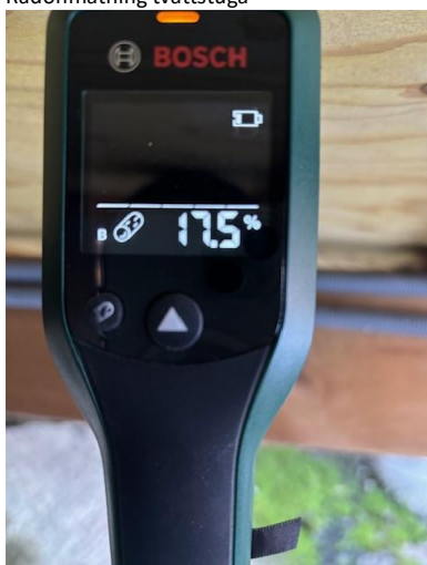
Fuktkvot i virke i plintgrund
