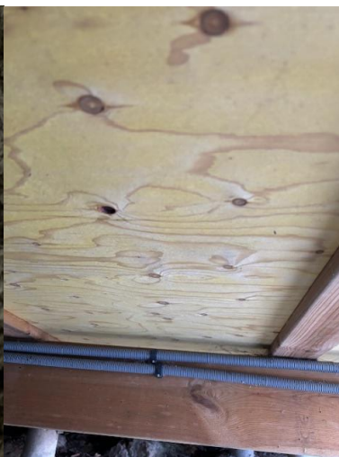
Missfärgning i plintgrundens bjälklagsbotten
